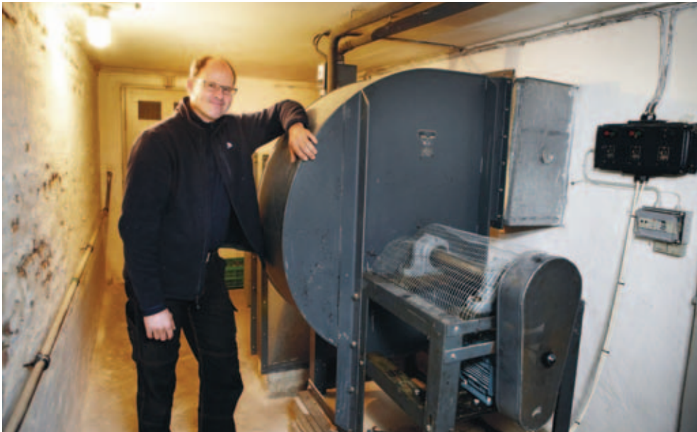
Den gamle varmeblæser i kælderen under Sct. Pauls Kirke har udsigt til sommerferie næste år takket være provstiprojektet.
